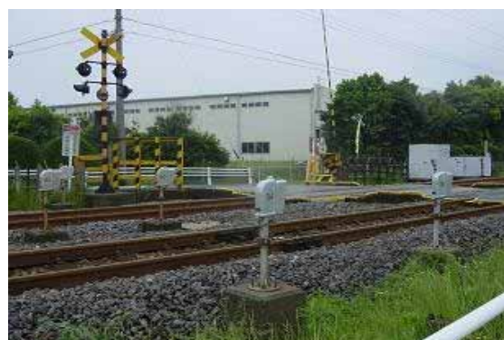
踏切支障報知装置
