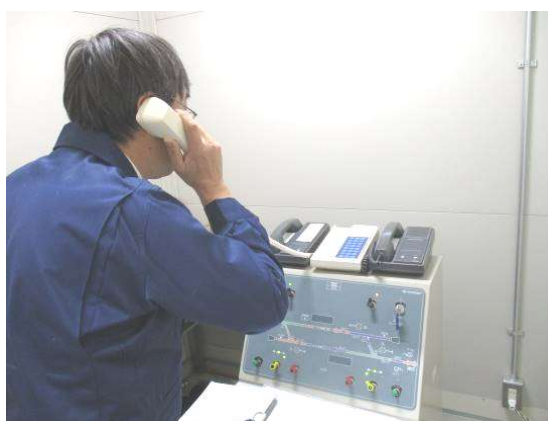
駅制御盤取扱い訓練
